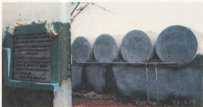
Kune-Ansute piped water supply scheme—A reservoir कुणे-अनसुटे नळ पाणी पुरवठा योजना-पाण्याची टाकी
